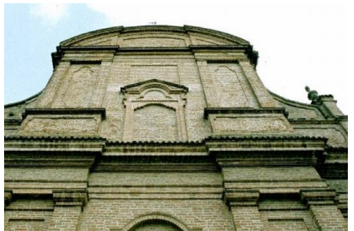
Fontana firma ordinanze per il ripristino di chiese con danni dal...
