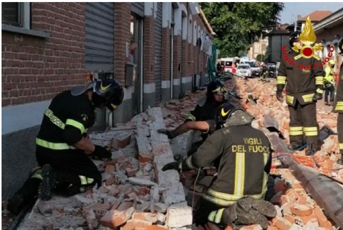
Crollo tetto Albizzate/Va, Fontana: immenso dolore, preghiera per vittime
