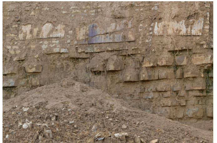
Da Regione risorse importanti per interventi sul dissesto idrogeologico
