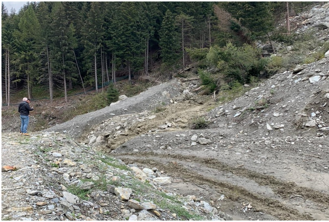
Frana Ruinon. Assessore Sertori: si riapre la Strada provinciale 29
