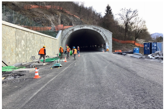
Variante di Zogno (Bg), Terzi: procede il cantiere finanziato da Regione - video
